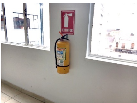
Extintores en oficinas
