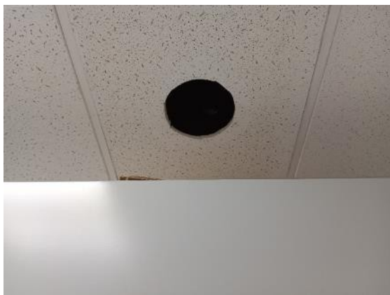
Afectaciones Cielo raso
