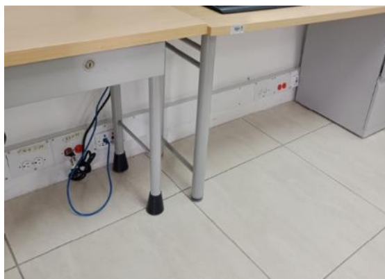
Cableado en canaleta
